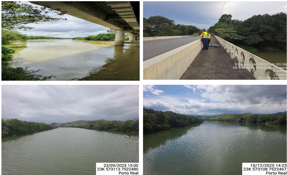
Figura 15 - Registros das quatro (04) campanhas de monitoramento no P-11 (Ponte Bom Retiro, em Porto Real - RJ)
